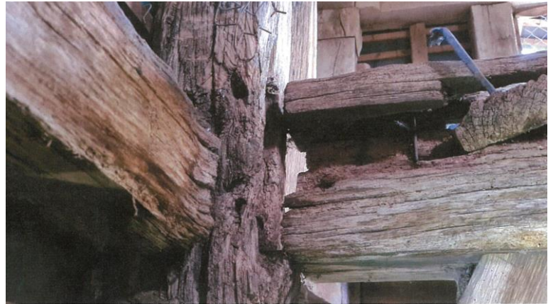
Maçonnerie désorganisée, bouts de poutres dégradées par l'humidité
